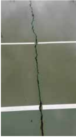
Grietas en las pistas antes de la reparación
